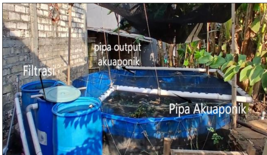
Gambar 2. Sistem akuaponik RAS setelah perakitan
